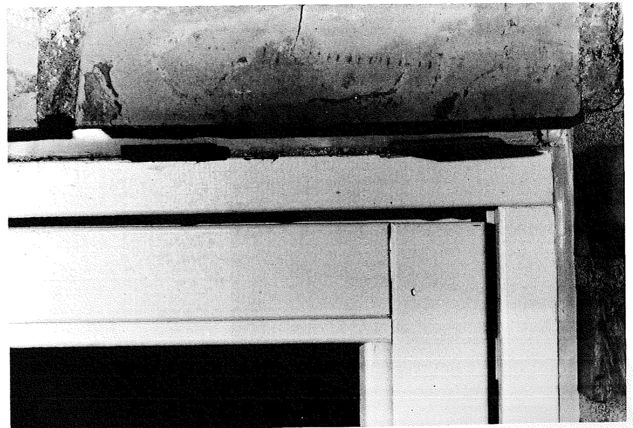
Figur 13. Nærbillede af fuge med kiler over vinduet.
