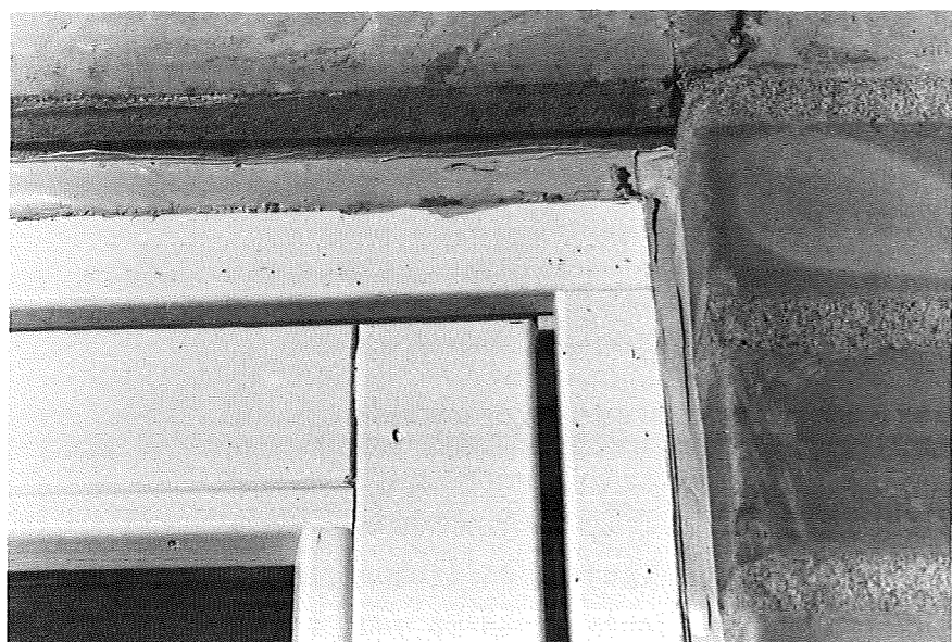
Figur 14. Flænger og huller i fugemasse.
